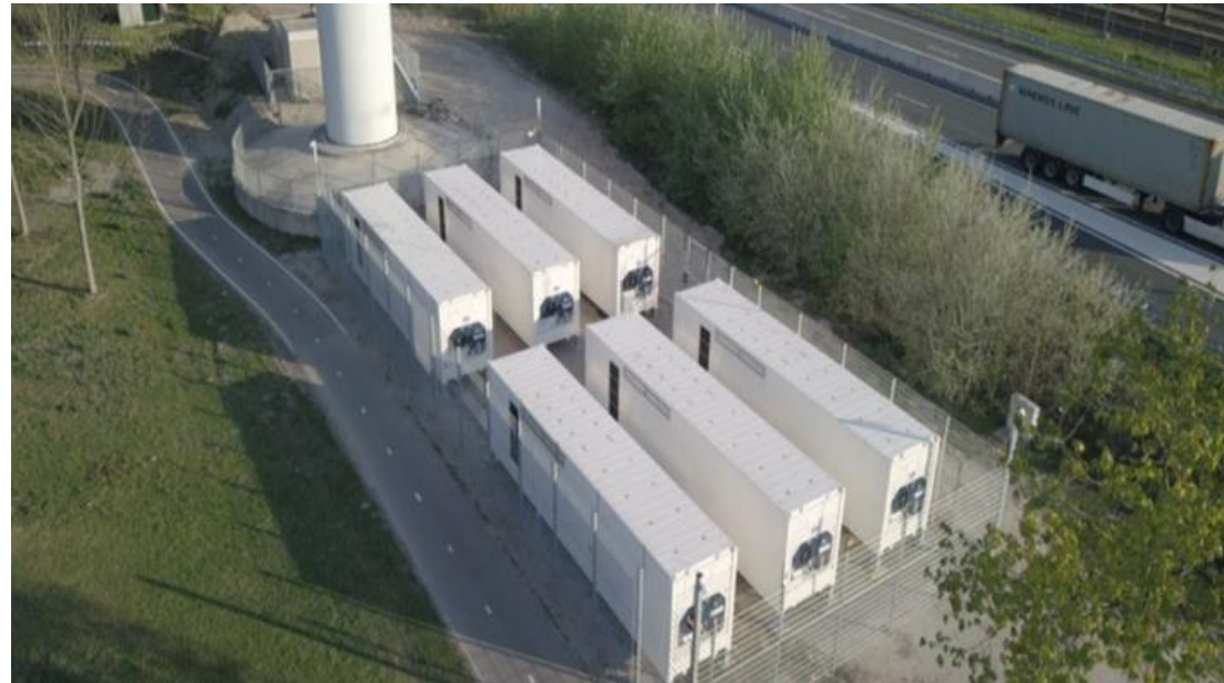
Energieleverancier Greenchoice heeft bij Windpark Hartelkanaal, tussen de N15 en het Hartelkanaal in Rotterdam, een groot batterijopslag.
